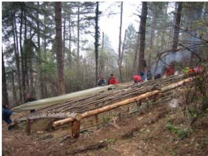
Sl.50 Postavljanje drvene konstrukcije za konzervaciju sonde S-12. (Photo: Špiro Gerao Čakčić, 01. novembar 2006)
